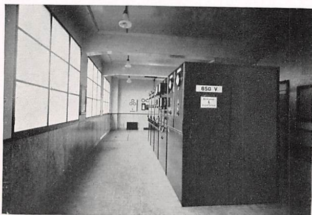
Automatisch onderstation (Vossem). Kwikzilverdampgelijkrichter met glazen peren.
